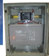
COFFRET ELECTRIQUE AVEC BATTERIE ET REGULATEUR
