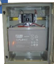
COFFRET ELECTRIQUE AVEC BATTERIE ET REGULATEUR
