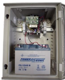
COFFRET ENERGIE AVEC BATTERIE, CHARGEUR, BORNIER ET FUSIBLES DE PROTECTION
